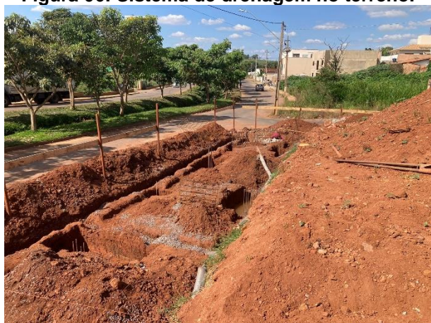
Figura 06: Sistema de drenagem no terreno.
